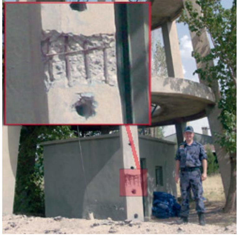
Şekil 6 - Kolonlardan birisinde beton ve donatı durumu
